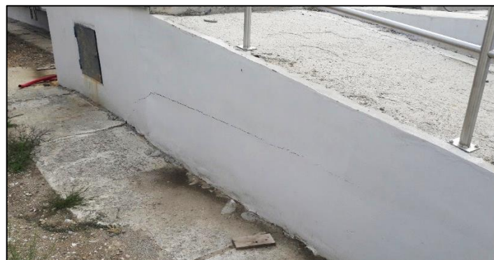
Obrázok 9: Reklamácia – porušenie stavebnej úpravy.
